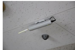
天井に設置されたRFIDアンテナ
